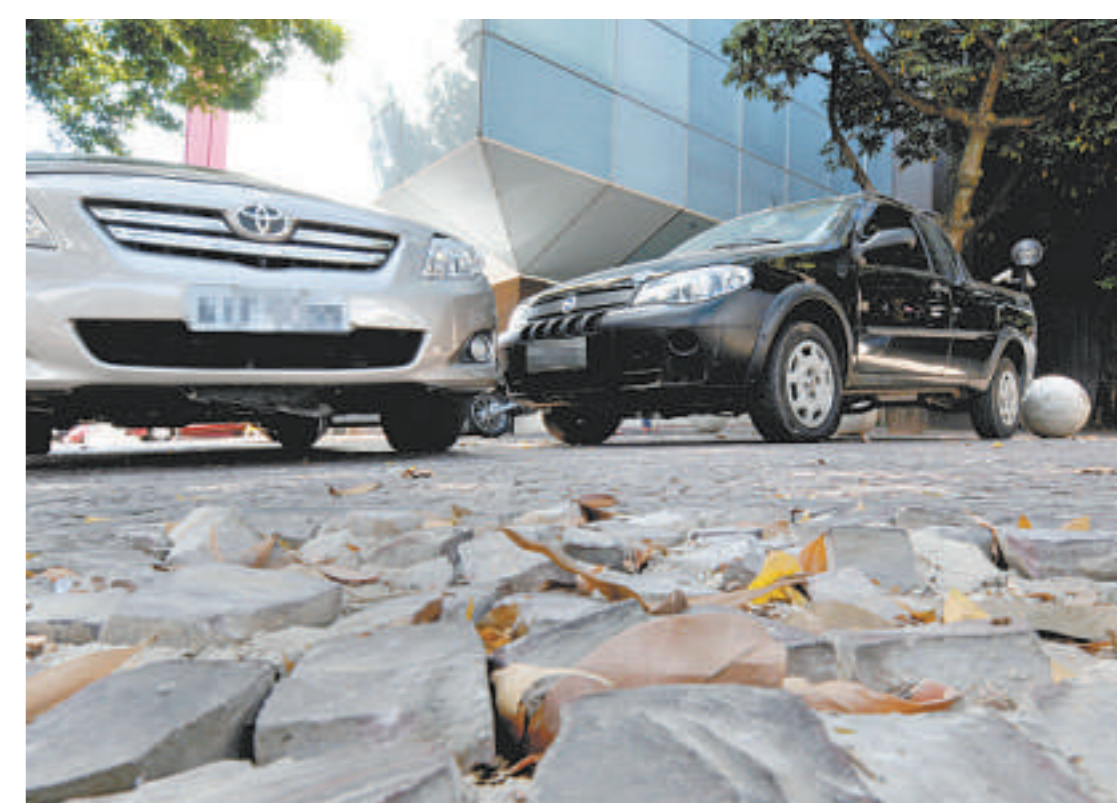
Passeios próximos ao Espaço TIM UFMG do Conhecimento estão esburacados por causa da invasão de carros
